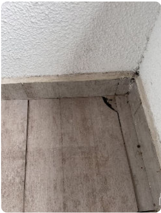
Cerámica fisurada (caso real). Base mal preparada o sin dilatación.
