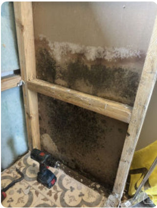
Humedad y hongos (caso real). Primero se trata la causa, después se repara.
