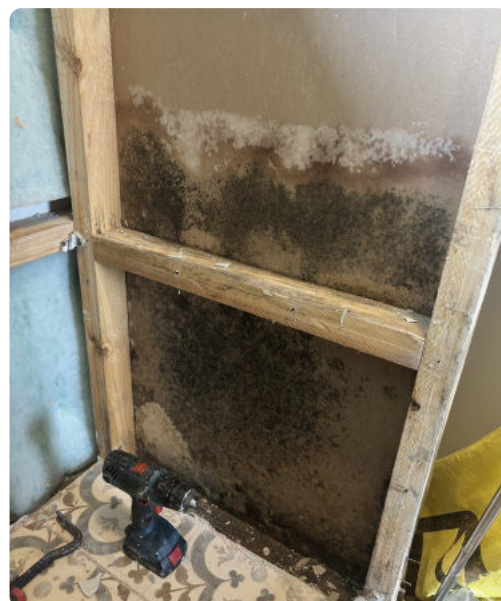
Hongos detrás de un revestimiento (caso real): primero se encuentra la causa.
