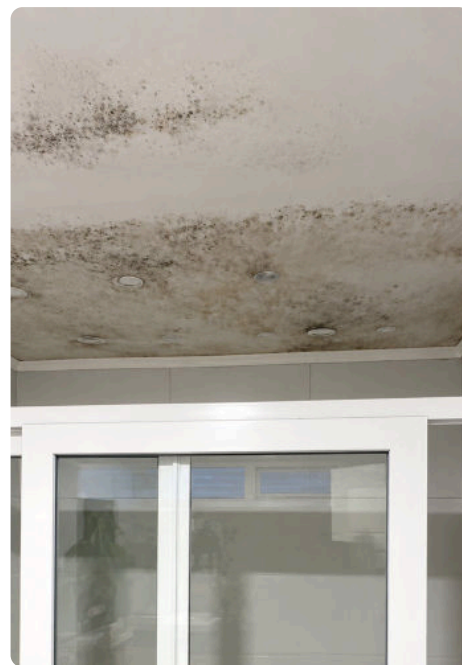
Hongos en el cielo de un baño sin buena ventilación (caso real).
